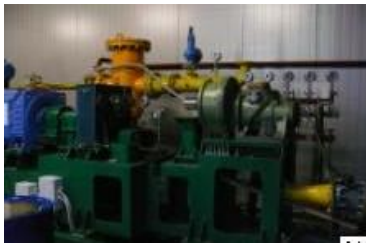
Standuri de testare compresoare si ventilatoare
